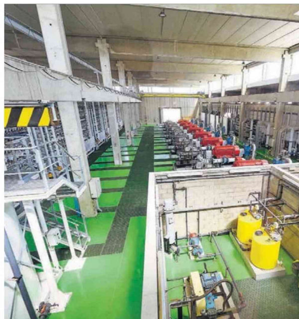
Interior de la desaladora de la capital almeriense. LA VOZ
